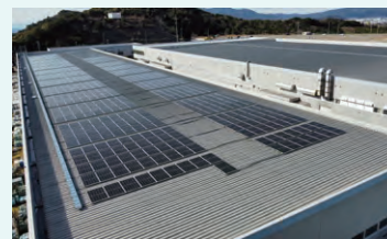
和歌山工場の太陽光発電設備
